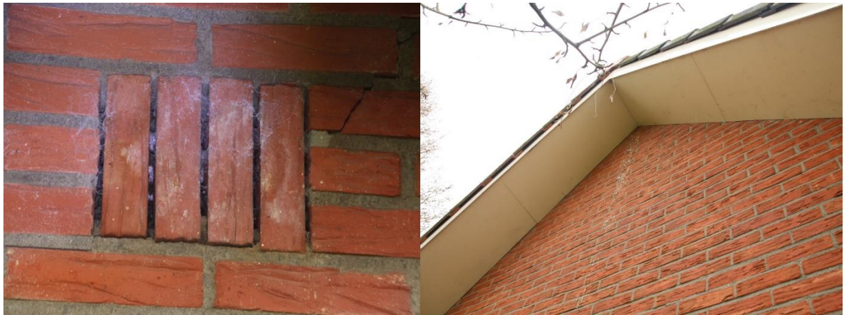
Foto links; ventilatieopeningen zijn bedekt met spinrag. Foto rechts; De betimmering van het dakoverstek sluit naadloos aan op de buitengevels.
