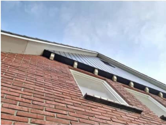
De betimmering van het dakoverstek sluit naadloos aan op de buitengevels en er zijn openingen tussen de houten topgevel en buitengevels vastgesteld.
