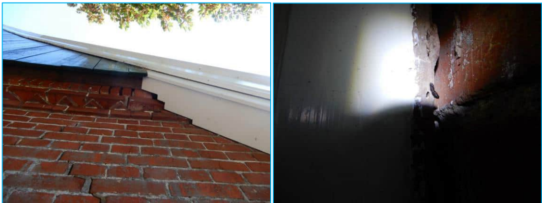
Foto's: Openingen waar vleermuizen gebruik van kunnen maken en uitwerpsel bij opening kozijn.
