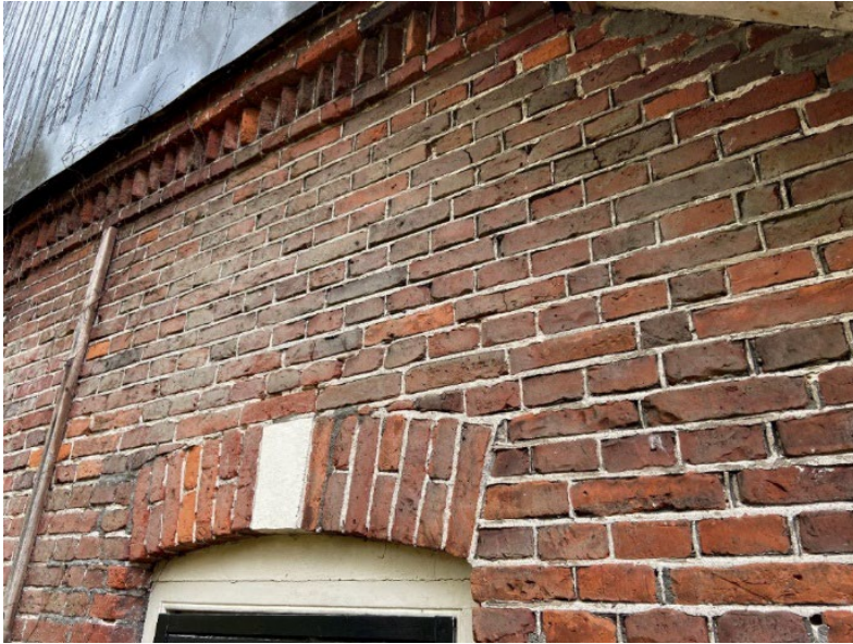
Afb. Steens metselwerk in kruisverband en een streks zaagrand net onder de topgevel
