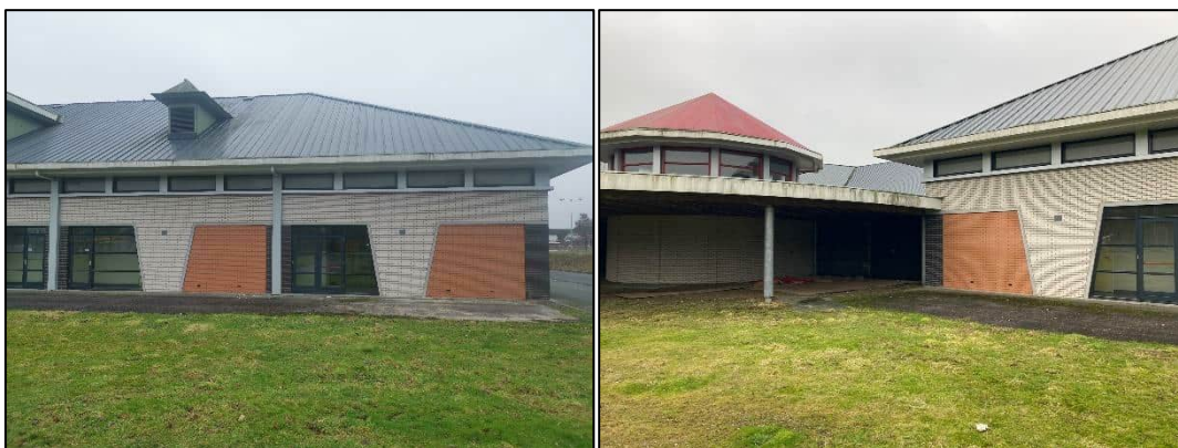
Figuur 1.2 (links): Noordaanzicht van het gebouw; Figuur 1.3 (rechts): Noordaanzicht van het gebouw, met de te slopen koepel.
